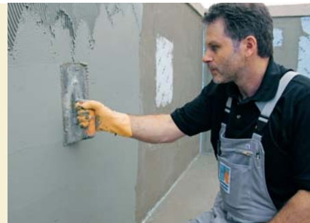
Wyrównanie powierzchni ścian niecki szpachlą betonową PCI Polycrret® 5 (1 - 5 mm), zaprawą wyrównawczą PCI Pericret® (3 - 20 mm) lub lekką zaprawą naprawczą PCI Nanocret® 100.
