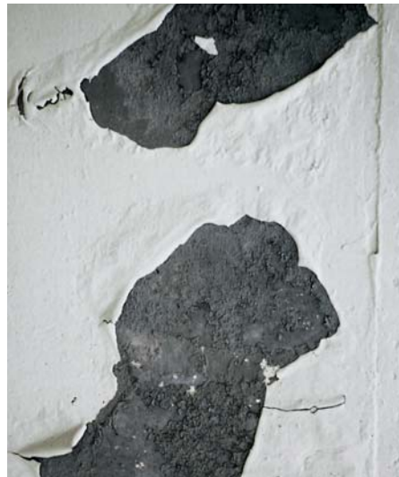
Warstwa uszczelniająca uszkodzona wskutek ciśnienia osmotycznego.
