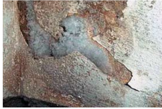
Krystalizacja soli budowlanych na skorodowanym tynku.
