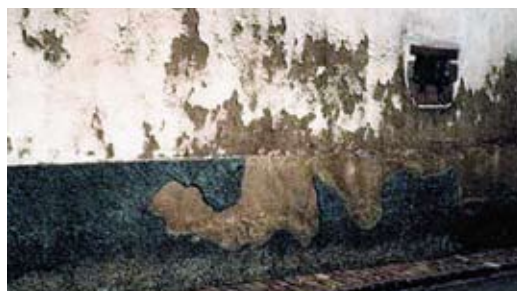
Destrukcja tynku w strefie cokolowej w wyniku krystalizacji soli (II etap).
