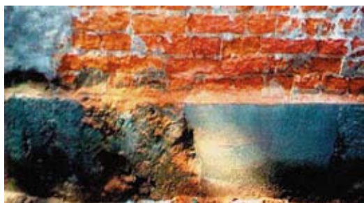
Destrukcja tynku w strefie cokołowej w wyniku krystalizacji soli (III etap).
