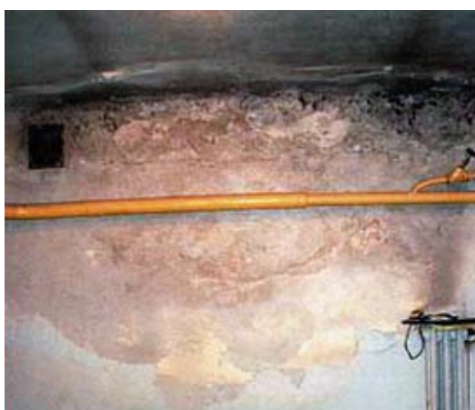
Destrukcja powłok malarskich, tynków i farby w strefie silnego zawilgocenia (napływ wód od strony zewnętrznej – masywny blok fundamentowy).
