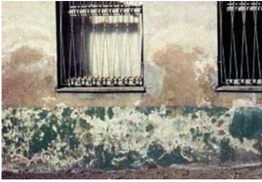
Degradacja tynku w wyniku krystalizacji soli.
