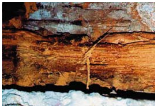
Porażenie zawilgoconych elementów drewnianych przez owady.
