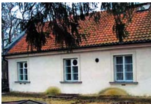
Zawilgocenie cokołu wywołane nieszczelnościami na połączeniu rynien.
