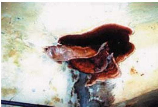
Porażenie budynku przez grzyba domowego właściwego.
