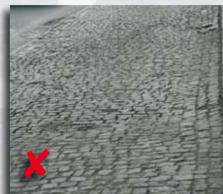
Zatoczka autobusowa przed remontem
